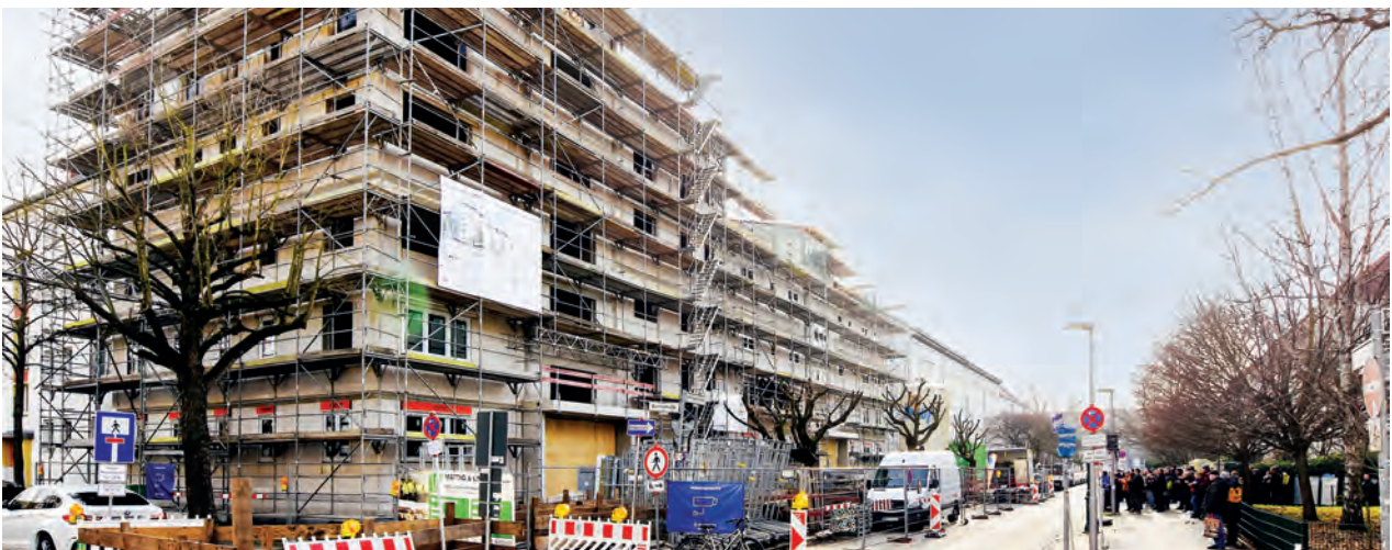
Richtfest für den Neubau der WG MERKUR eG in Lichtenberg | Alle Fotos © BBT
